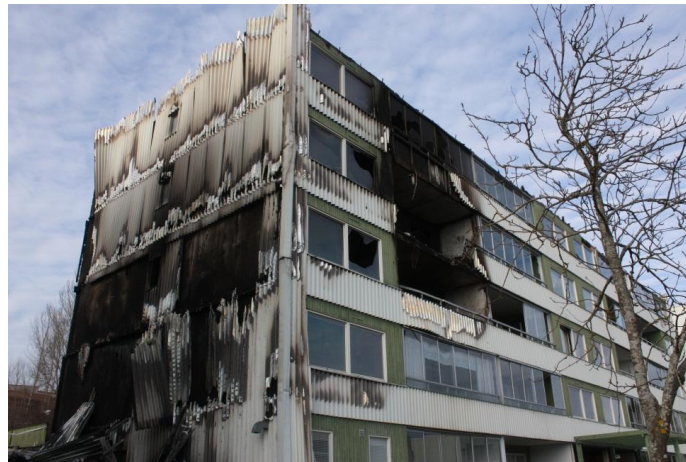
Figur B 4: Brannskader på bygningens østre langside og gavlveggen mot sør.
