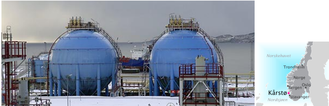
Bilde 5: Kårstø Prosessanlegg (Entry)
