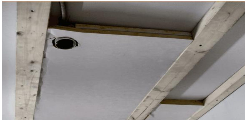
Figur 5.11: Foto av himlingsplatenes utforming og plassering over himlingen. Foto: tilsendt av prosjektet.
