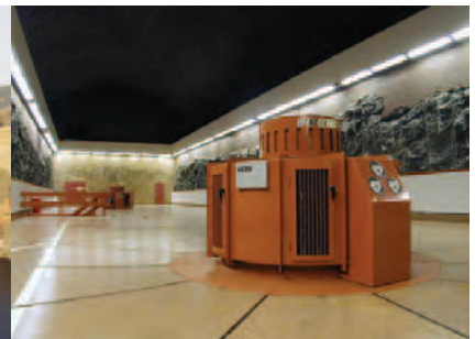
Bratsberg kraftverk ble satt i drift i 1977. Her ser vi toppen av generatoren inne i stasjonsbygningen.
