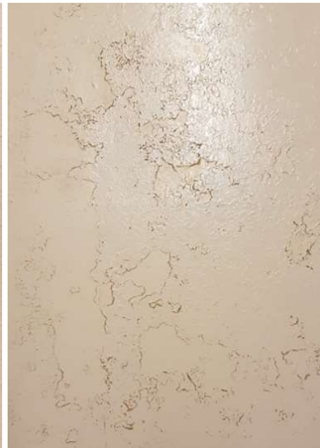
Figur 4.16: Mulig fuktskade på gulv langs vegg 2
