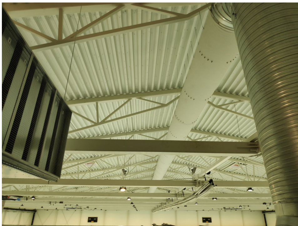
Figur 2.6: Tekstilkanal langs himling. Avtrekksrist synlig til venstre.
