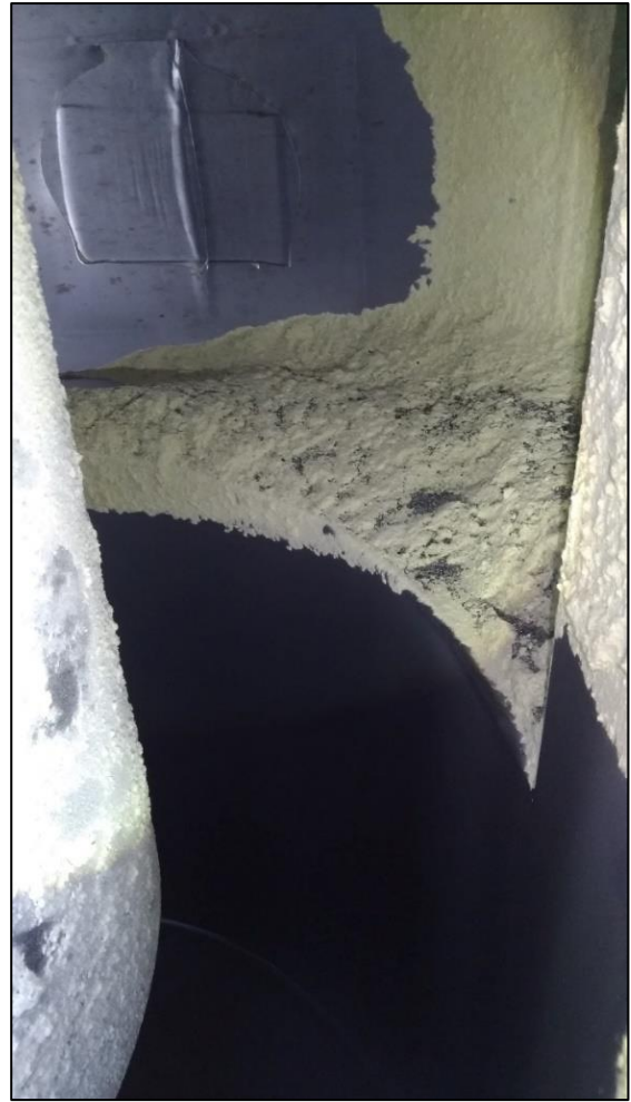
Figur B.8: Groing og lappet slitasje
