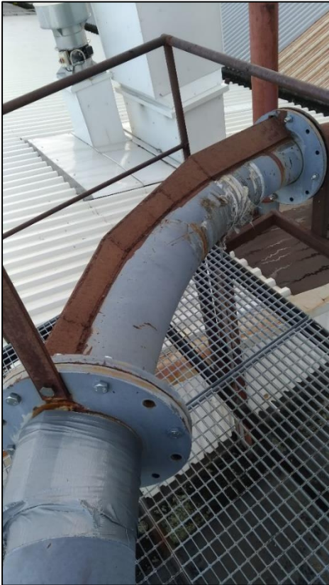
Figur B.2: To flenser i bend på tak mangler bolter
