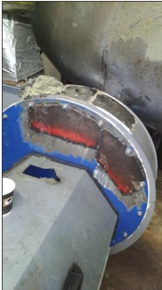
Figur 4.17: Slitasje og reparasjon på vifte
