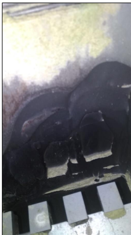
Figur 4.7: Slitasje på innsiden av sneglehus
