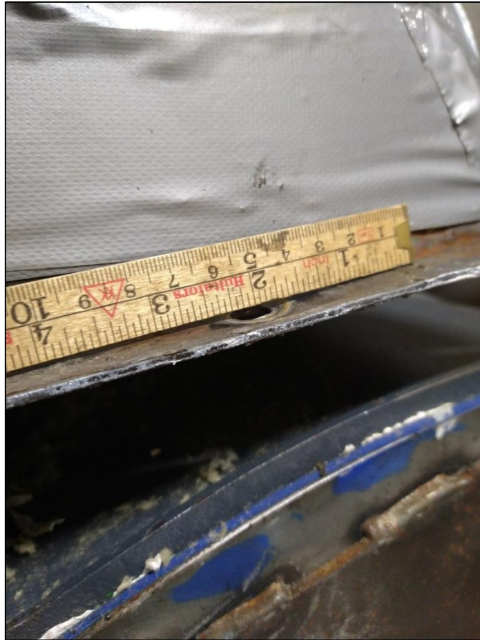
Figur B.11: Deformert flens på syklovifte
