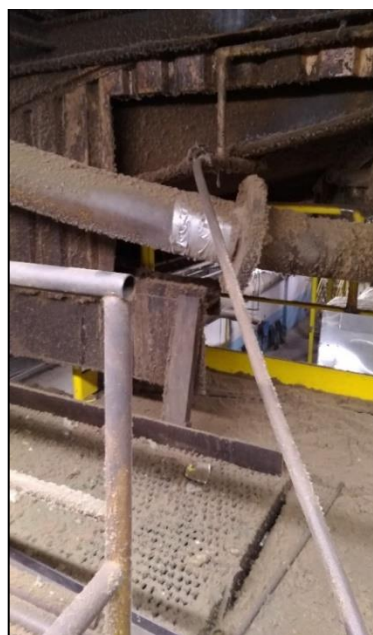
Figur 4.8: Lekkasje og reparasjon
