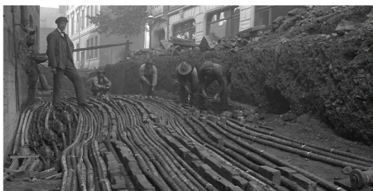
Kabler gravd direkte ned. Kilde: https://img.gfx.no/1733/1733517/1200011783.jpg
