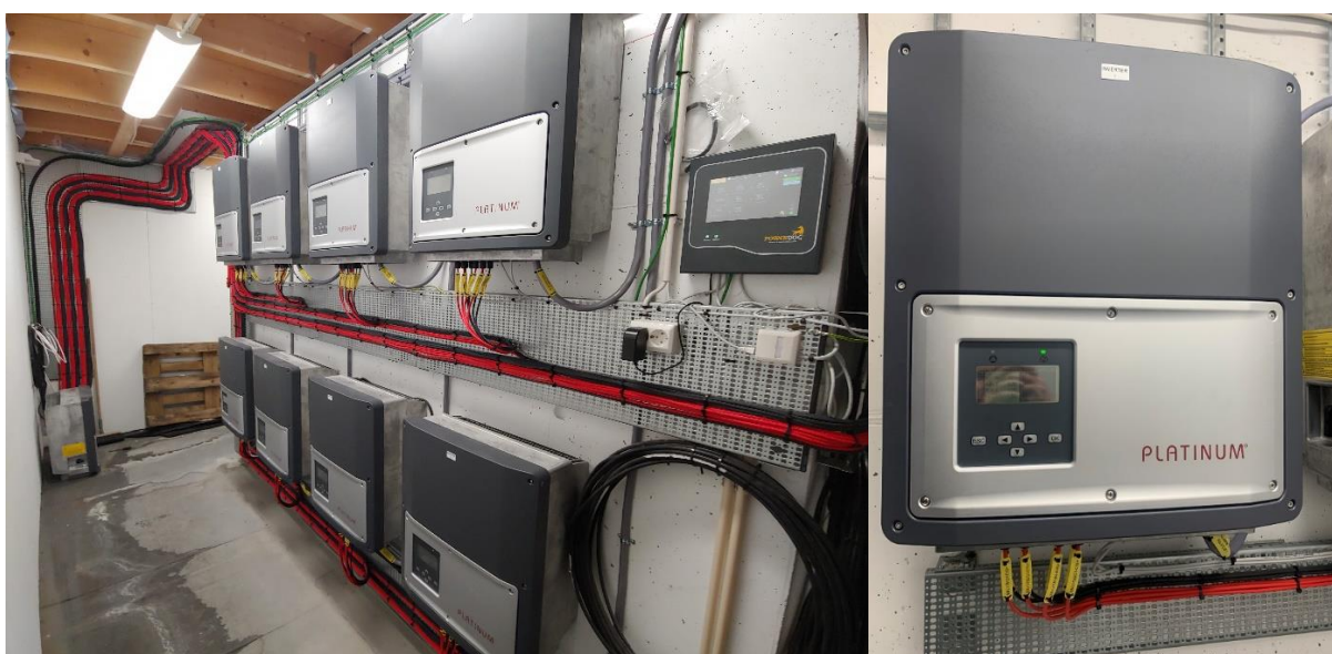
Figur 25: Rommet med vekselrettere Klar Energy i Hareid
