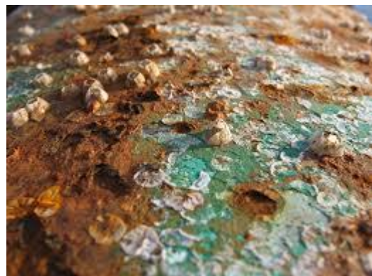
Figur 4.29 Materiale påvirket av korrosjon (Korrosjon, 2019)
