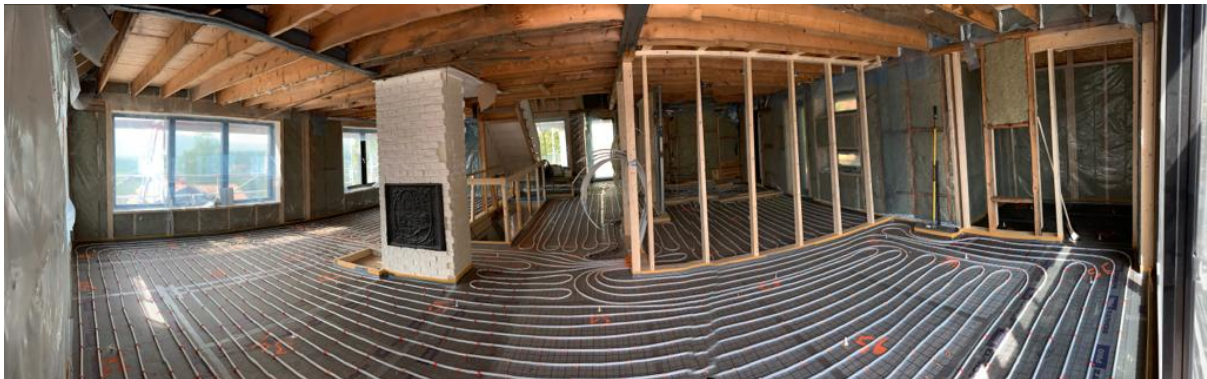
Figur 3.5: Vannbårent gulvvarmesystem i første etasje. Foto: Lindberg&Thorud
