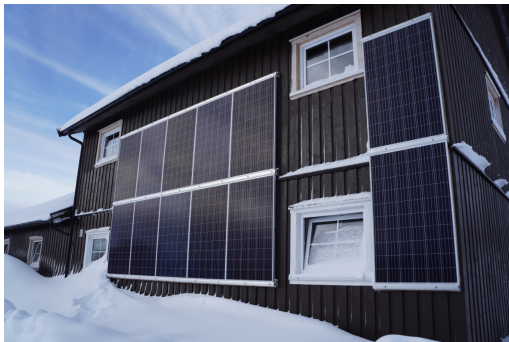
Solcellepanelene plasser på fjøset
