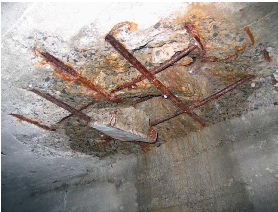
Figur 32. Skade på betong som følge av korroderende armering.
