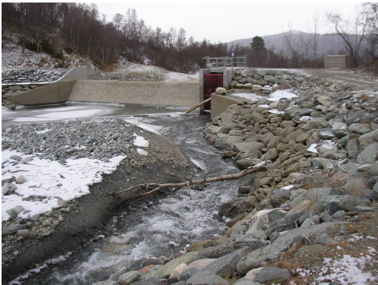
Figur 5.2: Sedimenteringsdammen høsten 2010 før tømming. Til venstre sees kornfordeling med grus og silt med et lag av grovere sedimenter på toppen. Foto: Stine Waldum
