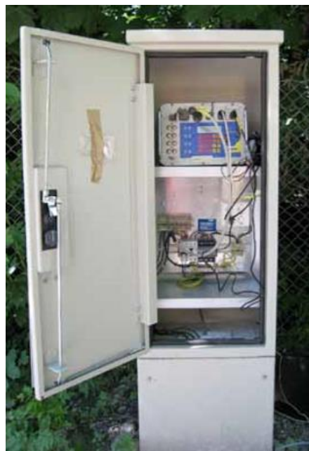
Figur 11 Et typisk skap med utstyr for registrering nivå 1 (V714 ,2011)
