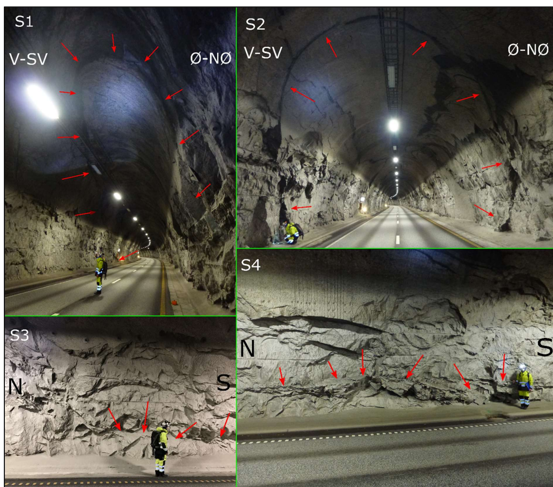
Figur 39 Eksempler på sprekker fra de ulike sprekkesettene observert i felt.
