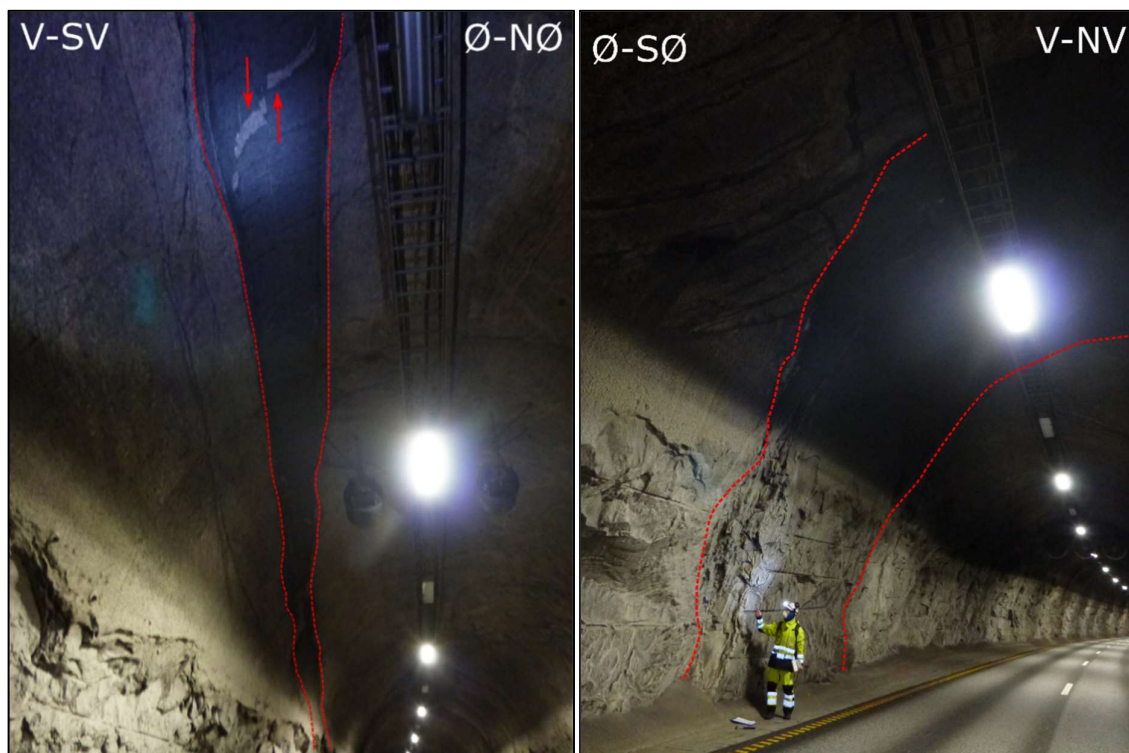
Figur 40 Sone med mørkt mineral og kinematisk indikator som går over hengt til tunnelen. Sonen har ved måling omtrent samme orientering som en S1 sprekk. Det er også større grad av oppsprekking der sonen treffer veggen i tunnelen.
