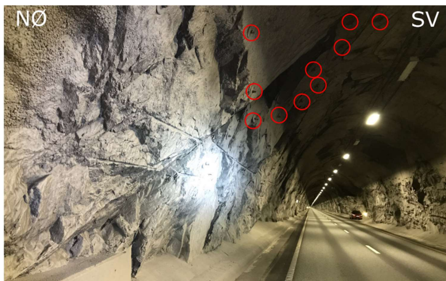
Figur 37 Bolting opppe i TBM konturen i hengt som følge av større sprekker. Boltene er avmerket med rød sirkel.
