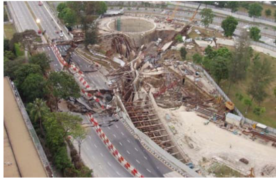
Figur 2.2: Oversiktsbilde av byggegropen etter kollaps (Endicott, 2015).
