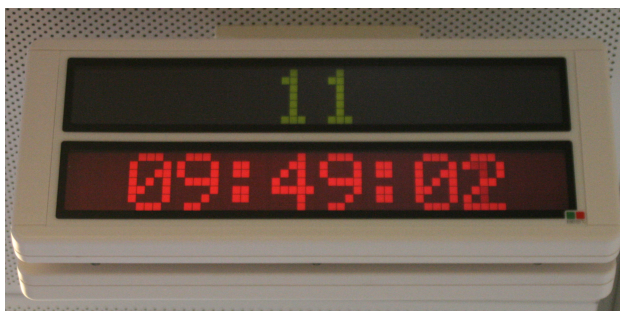
Figur 2.7: Panel i taket for varsling av pasientsignaler og hasteanrop. Foto: Privat
