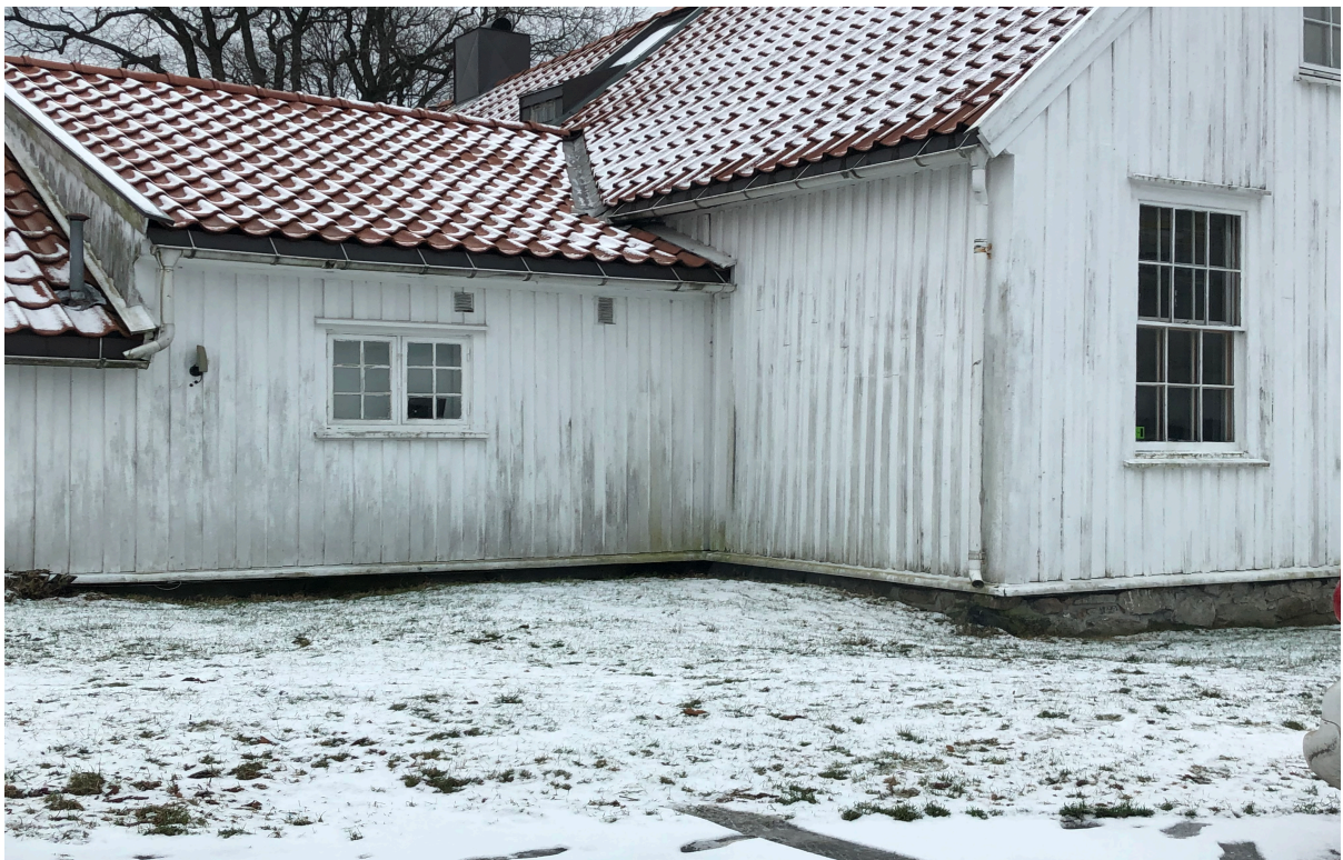
Figur 14.) Enda et bilde av sort belegg på veggene på Stiftegården. Som en ser er det slik rundt store deler av bygningen, men at det avtar litt hvor grunnmuren går litt høyere opp. Ellers synes det å være verst nederst på panelet. Foto: Andreas Bakken, 21.01.2019
