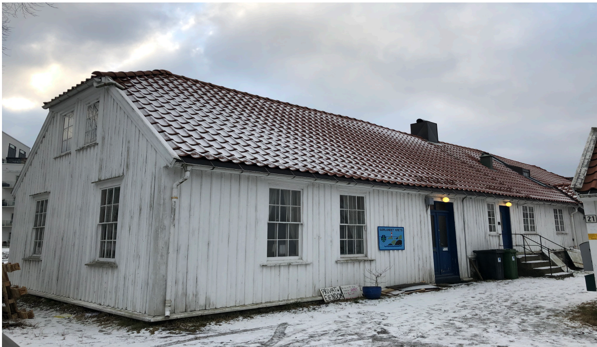
Figur 13.) Bildet viser sort belegg på Stiftegårdens hvitmalte vegger. Her fra langsiden av bygningen, man ser også at bygningen har en lav grunnmur. Sett mot vest. Foto: Andreas Bakken, 21.01.2019
