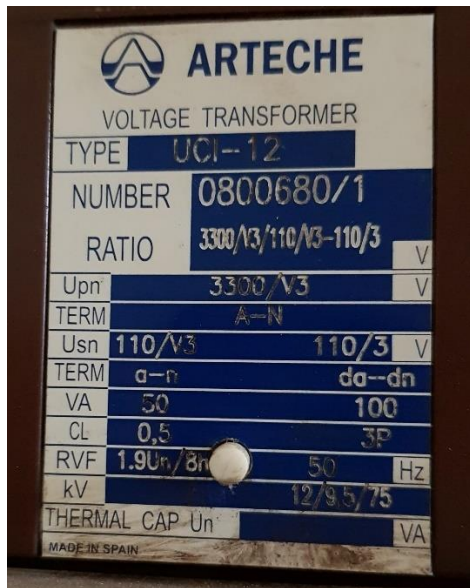
Figur 10.5:Måletrafo Ulefoss: Spenningstransformator
