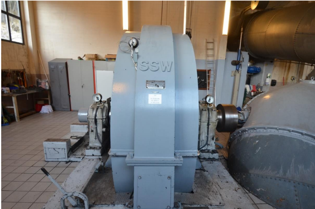
Figur 6.4: Generator på Ulefoss kraftstasjon. Foto: arkiv FAC [9]
