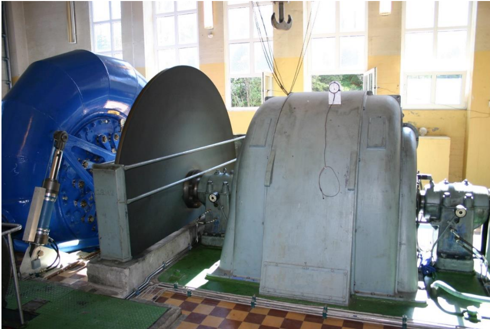
Figur 6.5: Generator på Liafoss kraftstasjon. Foto: arkiv FAC
