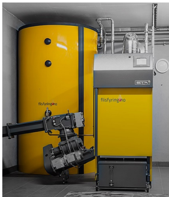
Figur 3.4: Fliskjel med installert effekt på ca. 50 kW inkludert akkumulatortank fra merket ETA (ETA, 2018)
