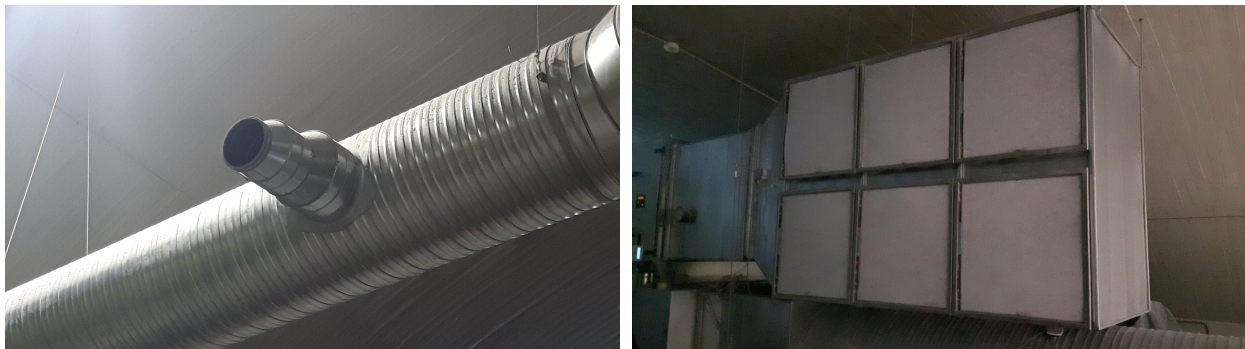
(a) Kanalåpning for tilluft.
