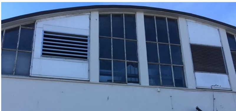
Figur 4.2: Ventiler for avkast og inntak av luft til ventilasjonsaggregatet i Trondheim Klatresenter. Avkast er plassert til venstre; inntaksrist til høyre. Foto: Jørgen Tonning Buch.
