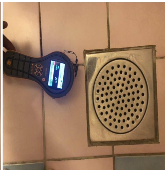
Fig. 20: Bad nr. 16 i vedlegget har påvist fuktinnhold ved gulvsluk. Foto: Kanu 2019
