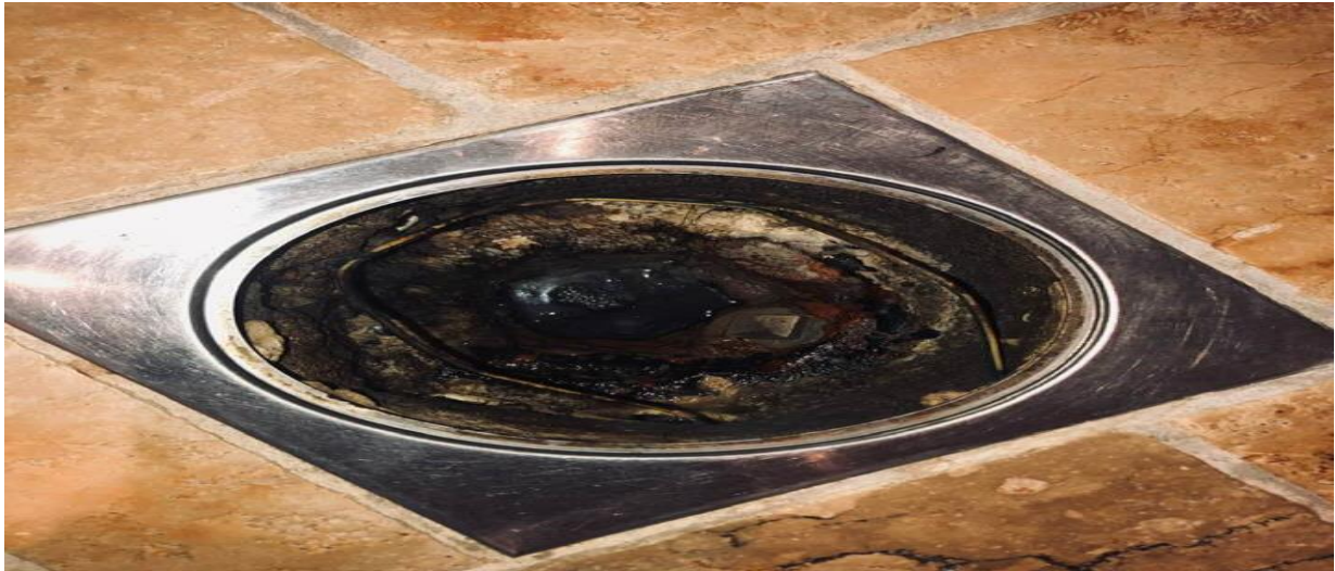
Fig. 23: Støpejernssluk som ikke ble byttet ved rehabilitering. Foto: Kanu 2019
