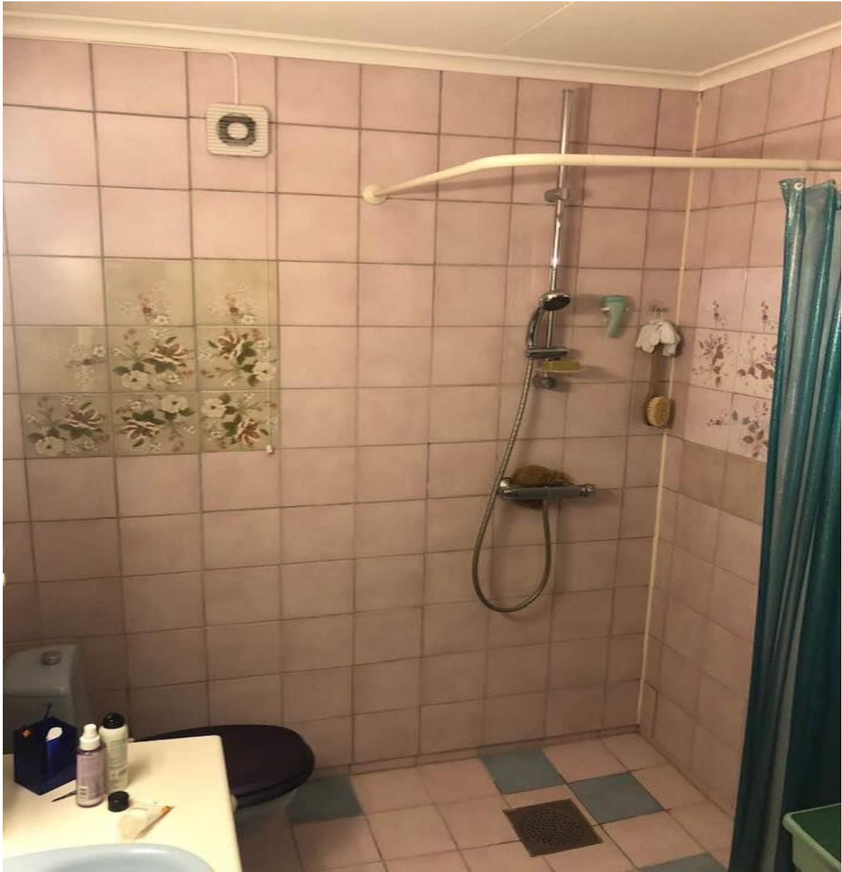
Bad fra 1982 med sprekker i flisfuger og løse fliser i vegg. Foto: Kanu 2019
