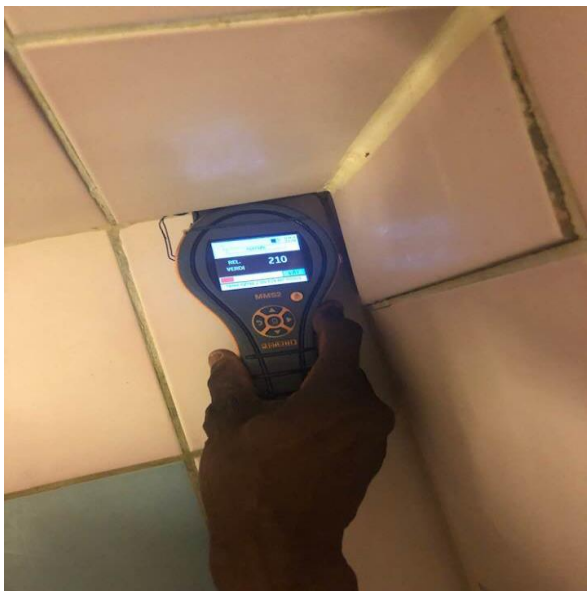
Fig. 19: Bad nr. 16 i vedlegget som har løsnet flis i gulv. Foto: Kanu 2019
