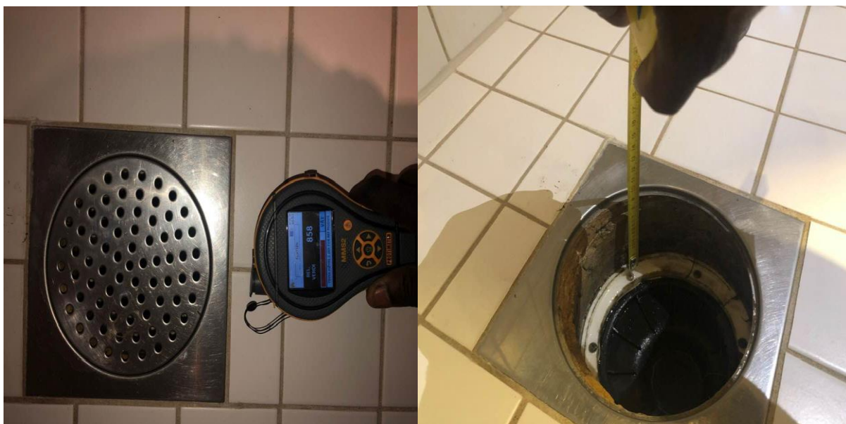
Fig. 21: Fuktig betonggulv. Foto: Kanu 2019
