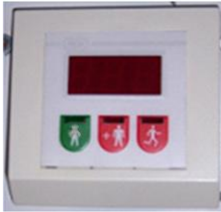
Figur 29: Panel i gammelt system ved dør
