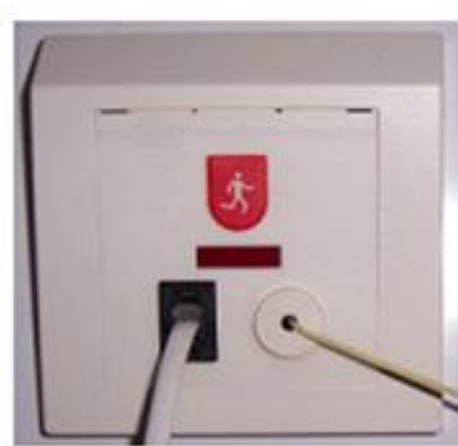
Figur 7: Panel for tilkalling inne på pasientrom ved seng
