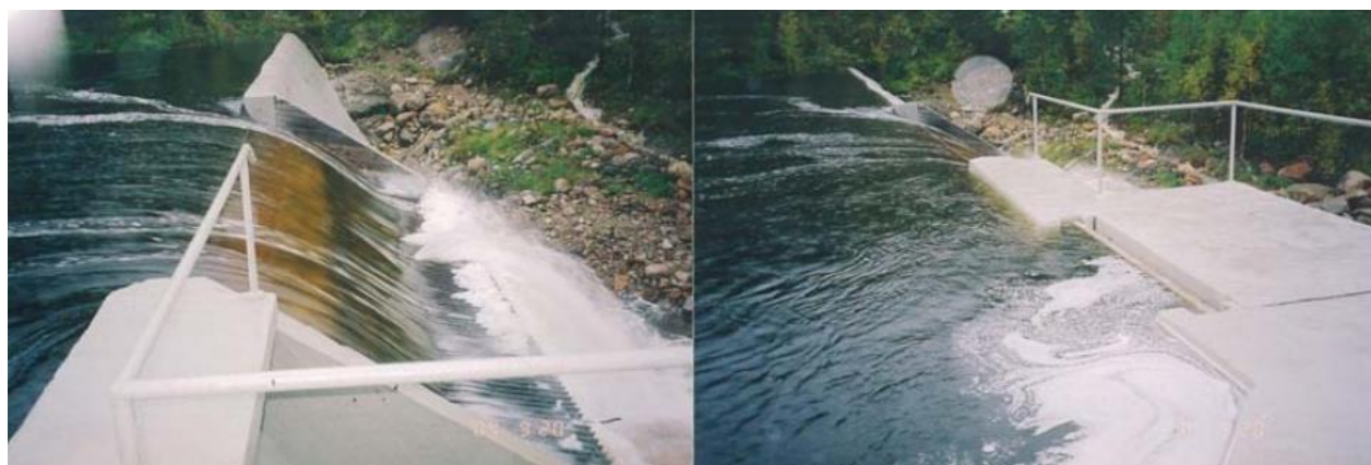
Figur 2: Tyrolerinntak under flom. (NVE, 2006)
