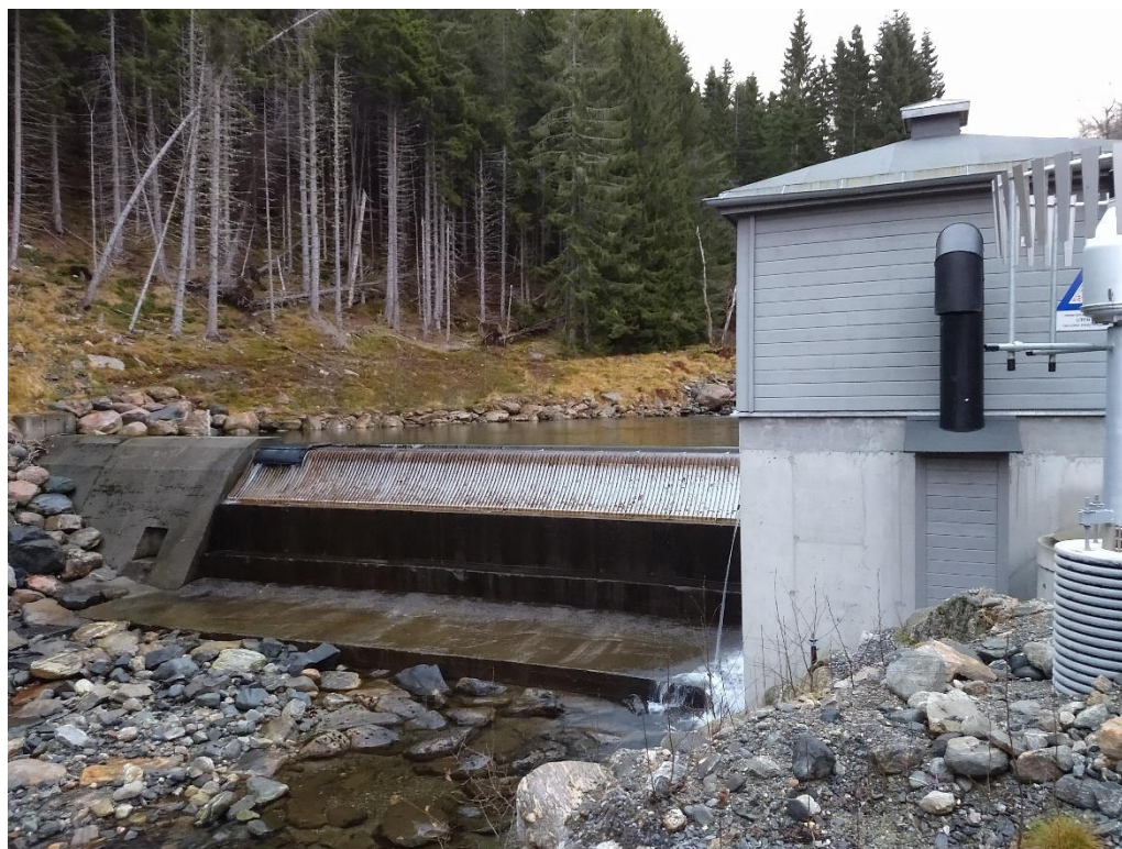
Figur 10: Inntaket til Dyrkorn kraftverk, med coandarist og prototype av snorkel.
