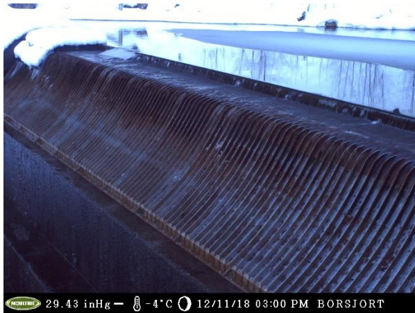
Figur 22: Bilde av inntaksrista klokken 15:00, 11.12
