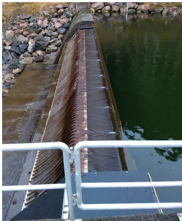
Figur 4: Coandaristen på inntaket til Dyrkorn Kraftverk. Snorkelen kan ses øverst på bildet, mens man nederst ser en ny type løsning for slipp av minstevannsføring. (Sæle, 2018)
