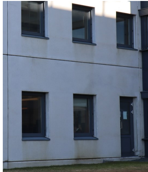
Figur 42: Sørveggen til Pir I 4, Trondheim (1987)
