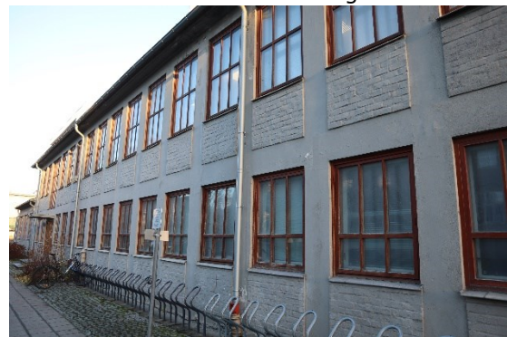
Figur 5: Brystningsfelt som avviker fra resten av fasaden mot vest. Foto: Anne Marie Grosås
