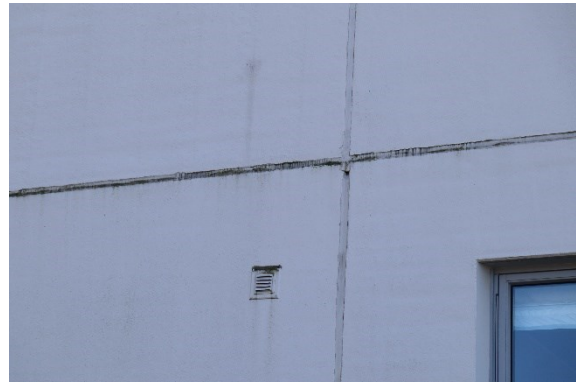
Figur 35: Nordvestveggen til Måseskjærveien 20, Bergen (2003)
