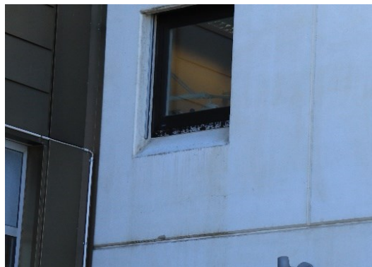
Figur 21: Østveggen til Pir I 4, Trondheim (1987)
