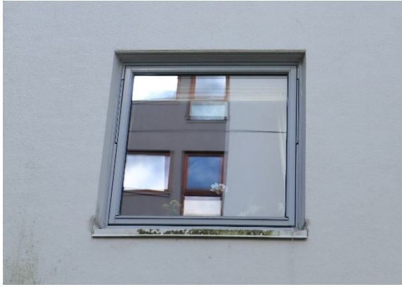
Figur 34: Nordvestveggen til Måseskjærveien 6, Bergen (2001)
