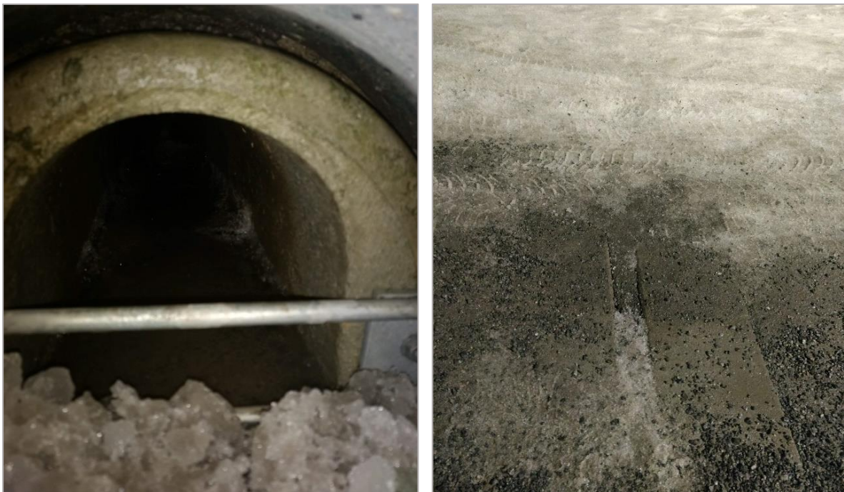
Figur 26. Det ble for første gang observert stillestående vann i den ene slisserennen. Bildet til høyre viser at en av slisserennene delvis var dekket av snø/slaps på overflaten.
