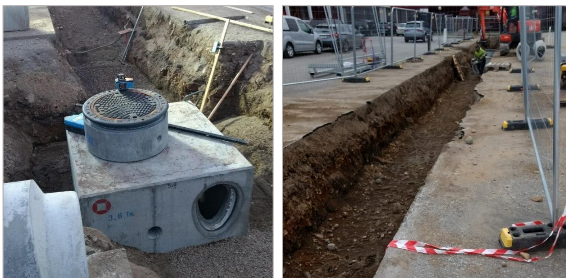
Figur 10. Sandfangskummen som er etablert midt på strekningen er illustrert til venstre. Bildet til høyre viser hele grøften, med delstrekningen uten fall nærmest.
