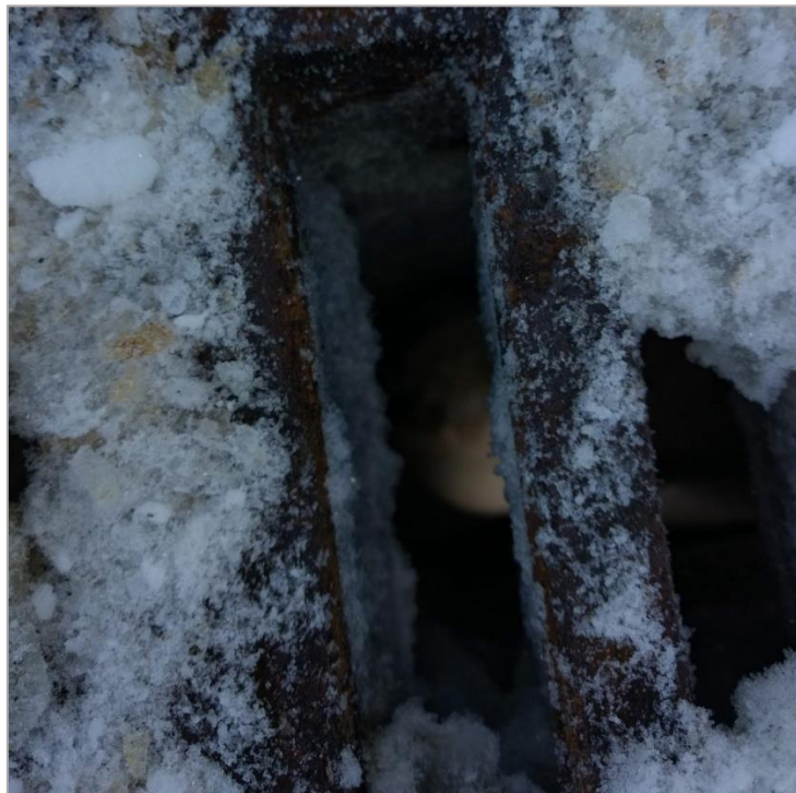
Figur 30. Dokumentasjon på at det kun ble observert litt snø nedi røret.
