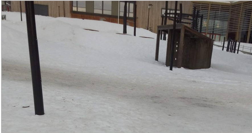
Figur 21. Overflaten var helt dekket av snø og is. Mellom de to lyktestolpene ligger den ene slisserennen.
