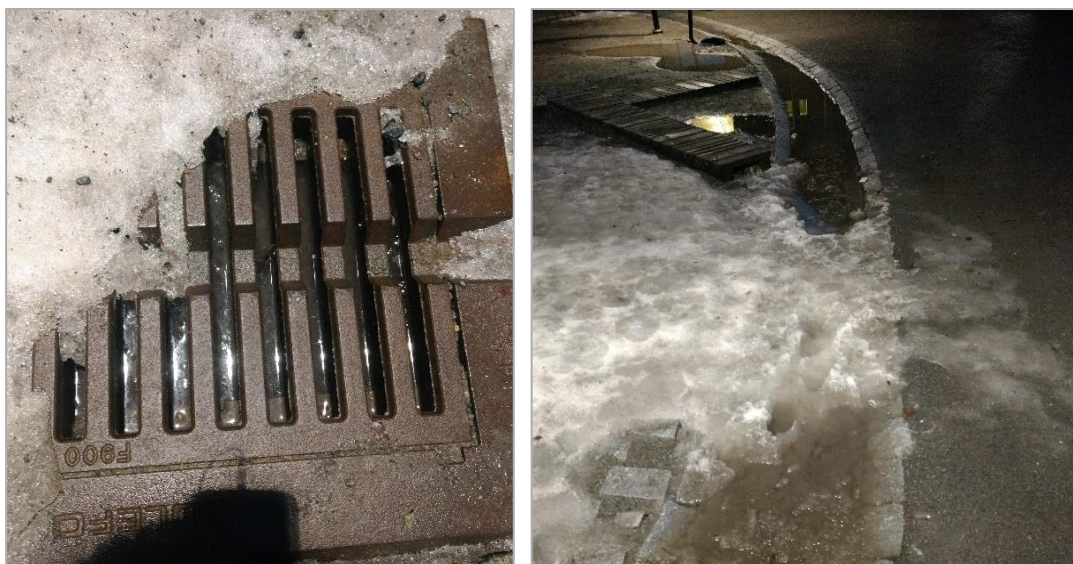
Figur 24. Det hadde samlet seg mye vann ved slisserennen som er tilknyttet det åpne vannspeilet.
