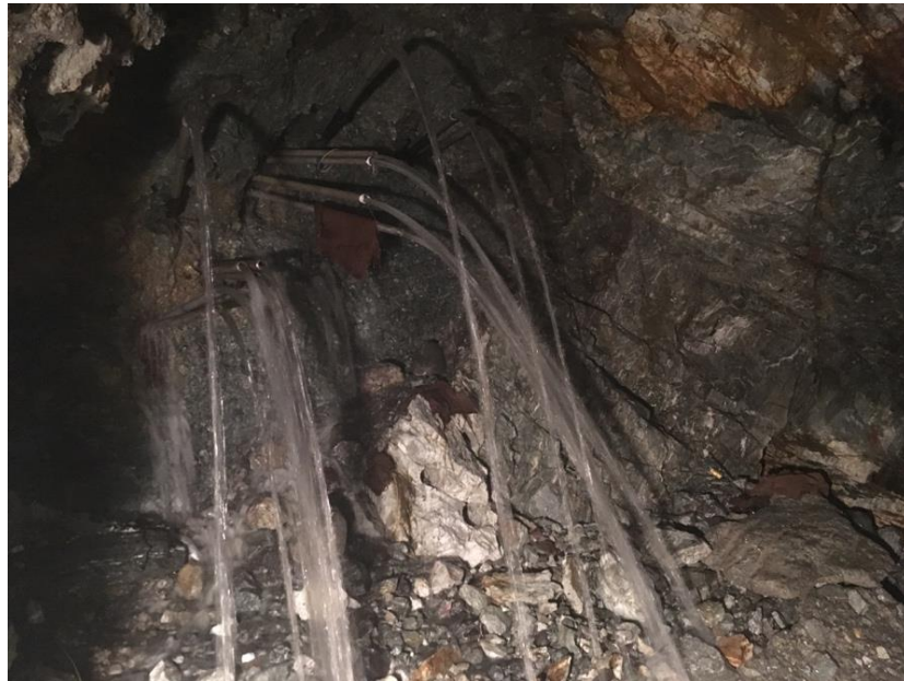
Figur 5.1: Innlekkasjer av vann gjennom en permeabel sone framme på stuff, under tunneldriving ved Mistri Khola kraftverk i Nepal. Lekkasjeproblemene medførte nedsatt framdrift for prosjektet. Foto: Håvard Barkved
