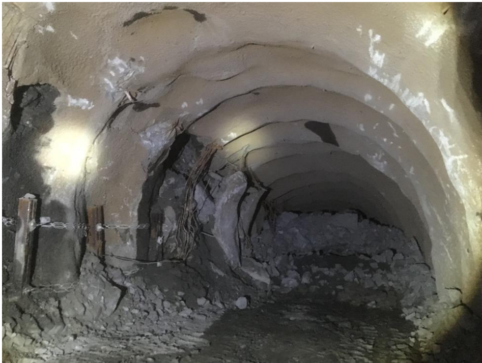
Figur 5.4: Fra ras i tilløpstunnelen ved Matre Haugsdal kraftverk i 2017. Raset gikk fra en svakhetssone som inneholdt svelleleire. Foto: Bjørn Nilsen
