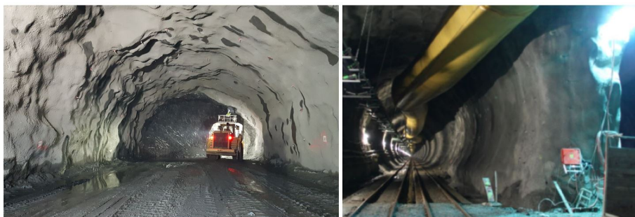
Figur 2.3: Venstre: Soknedalstunnelen drevet ved konvensjonell drift. Høyre: Ulrikken tunnel drevet med TBM (Rekve, 2017).
