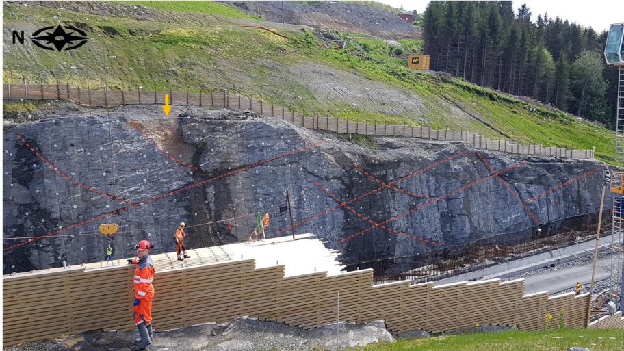
Figur 9.16: Også på skjæringen på østsiden av påhugg-sør kan foliasjonssprekkene og sprekesettet fra figur 9.14 vises. Slike sprekesett kan føre til utglidninger som vist med gul pil. Foran sees byggingen av den første portalen.
