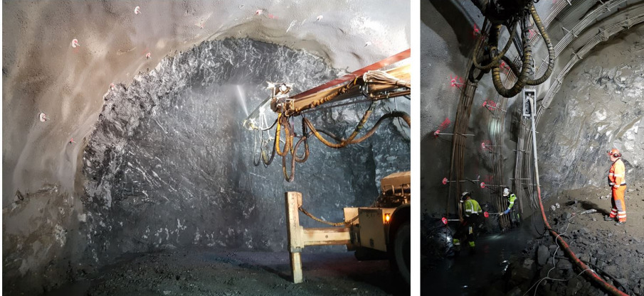
Figur 3.18: Venstre: sprøytebetong og systematisk bolting. Høyre: Sprøytebetongbuer for områder som trenger ekstra sikring.
