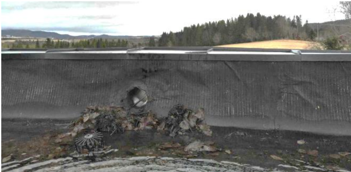
Figur 4.16: Sluk for innvendig taknedløp for drikkevannsbasseng 6.1 (Foto: Dillan Ø., Mattilsynet)
