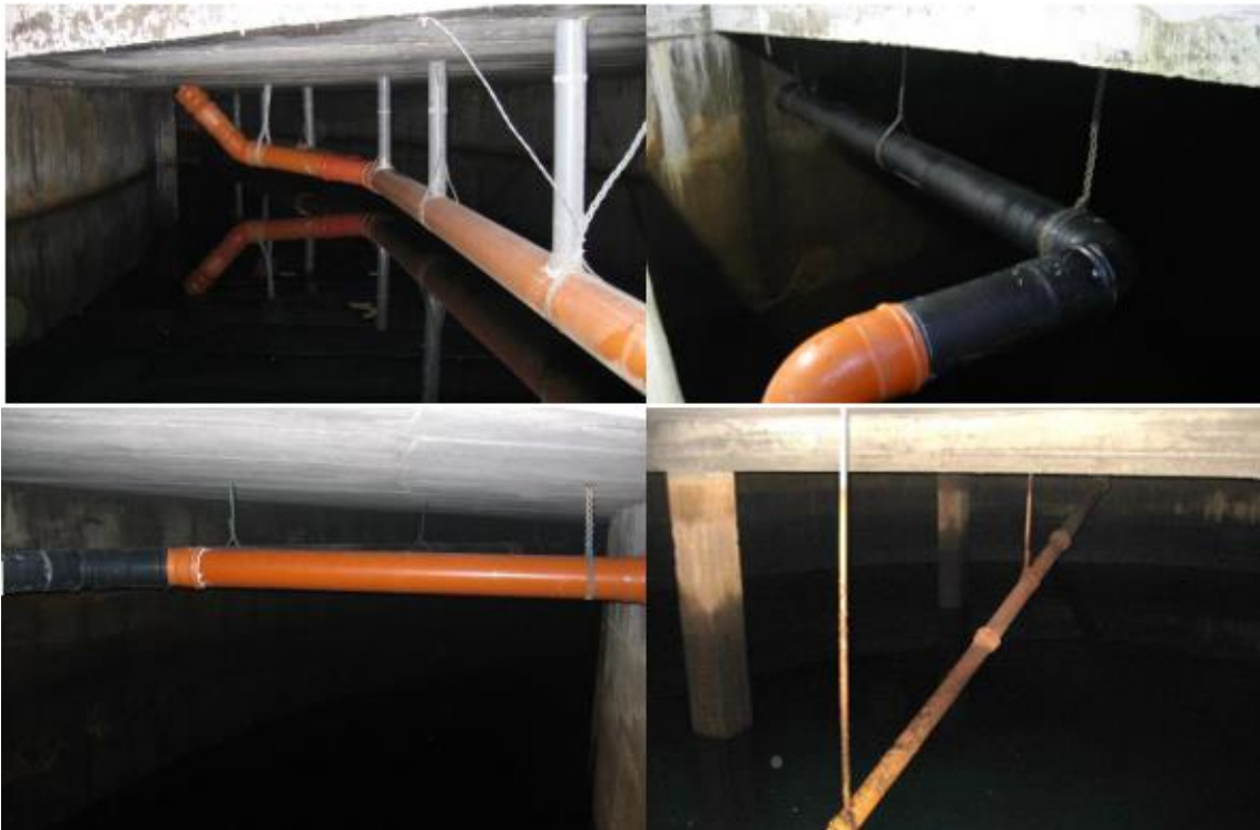
Figur 6.1: Viser hvordan avløpsrøret til utvendig sluk kan se ut på innsiden av et vannkammer (Foto: Roger Jarnstedt, Ancistrus AS)
