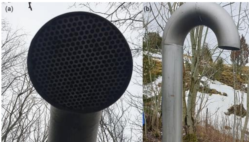
Figur 4.20: Lufting av vannkammeret for drikkevannsbasseng 6.2 via svanehals med netting (Foto: eget)
