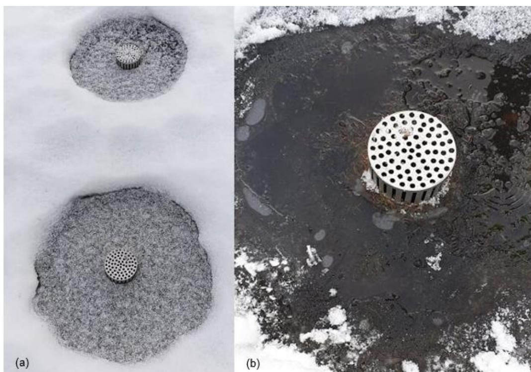
Figur 4.12: Sluk for innvendig taknedløp for drikkevannsbasseng 4.2. (a) viser hvordan det så ut før snøen ble fjernet. (b) Viser et nærbilde av ene sluket. Vannet som står på taket har fryst med masse barnåler og løv rundt sluket (Foto: eget)
