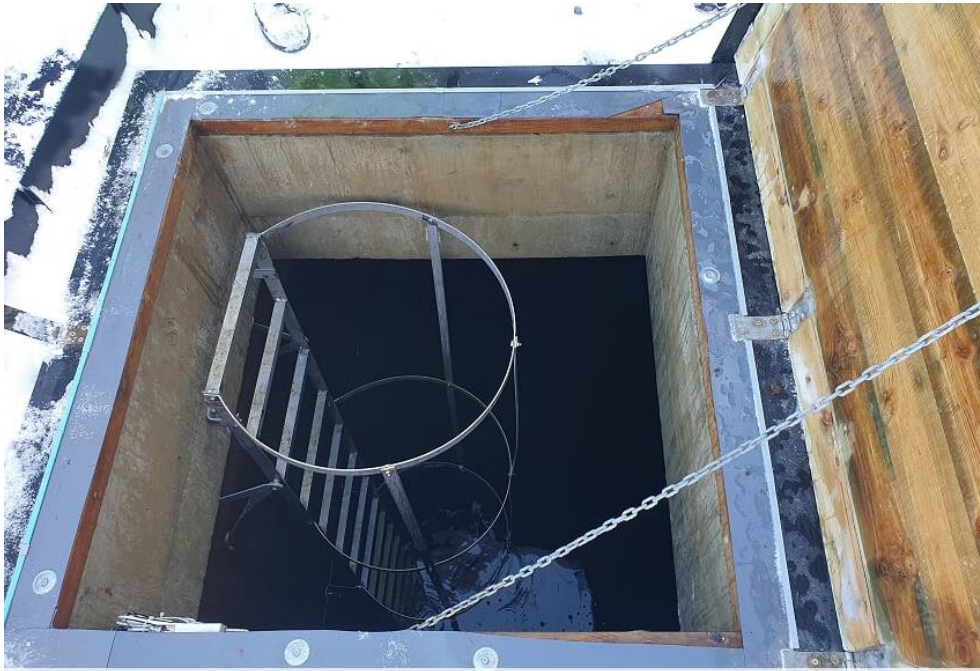
Figur 4.14: Utvendig nedstigningsluke for tilgang til vannkammer for drikkevannsbasseng 5.1 (Foto: eget)
