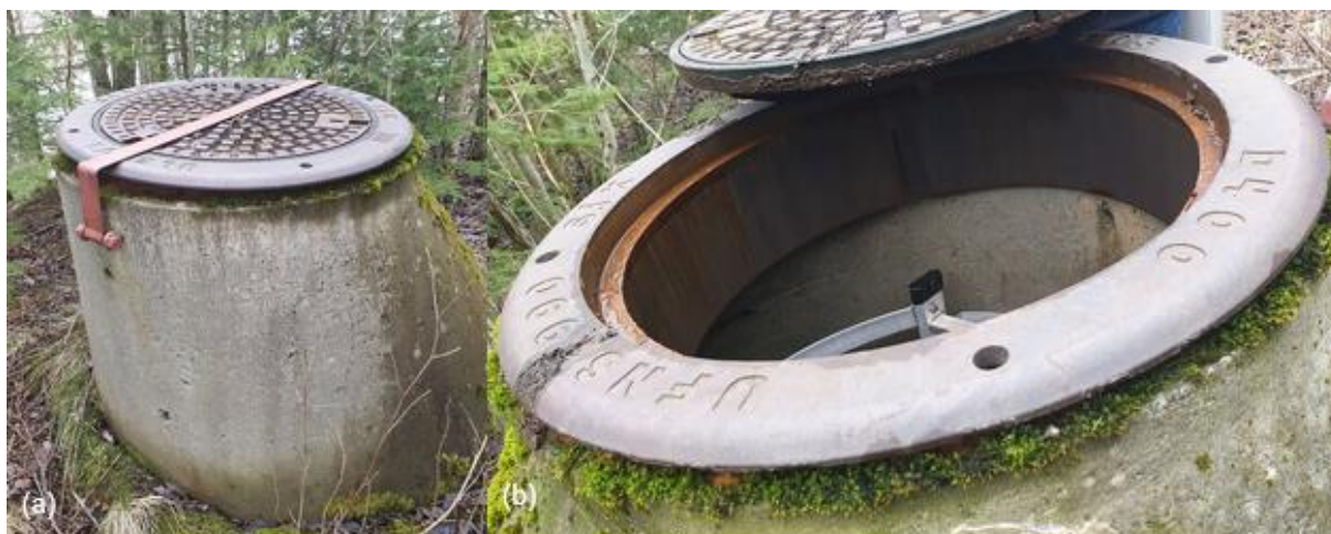
Figur 4.19: Tilgang til drikkevannsbasseng 6.2 gjennom kumløkk (Foto: eget)
