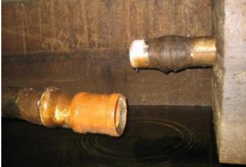
Figur 6.2: Viser et avkoblet avløpsrør som er koblet til utvendig sluk (Foto: Roger Jarnstedt, Ancistrus AS)
