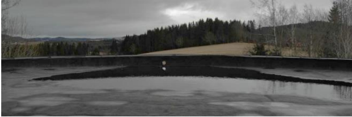
Figur 4.17: Vann som blir stående på taket på grunn av tett sluk for drikkevannsbasseng 6.1 (Foto: Dillan Ø., Mattilsynet)
