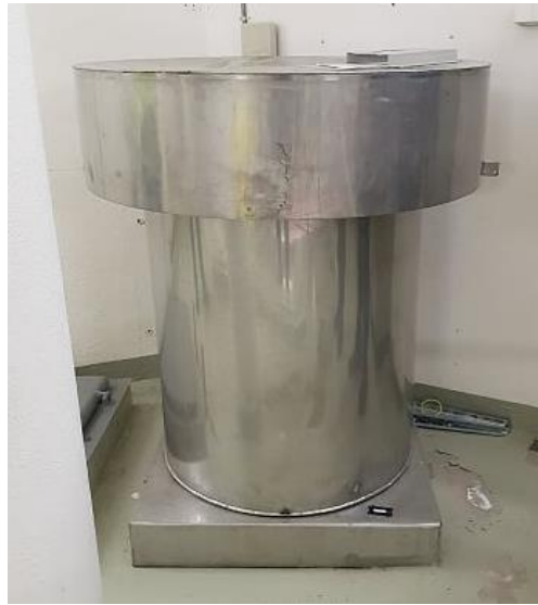
Figur 4.5: Ventilasjonsanlegg med filter. Luften trekkes inn på undersiden av luken på toppen hvor det er installert filter for rensning av luft før den tilsettes drikkevannsbasseng 2.3 (Foto: eget)
