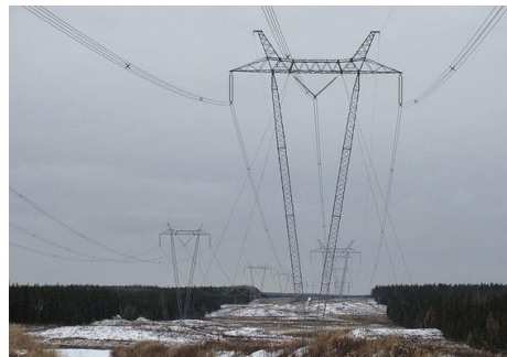
(d) V-guyed suspension tower.
