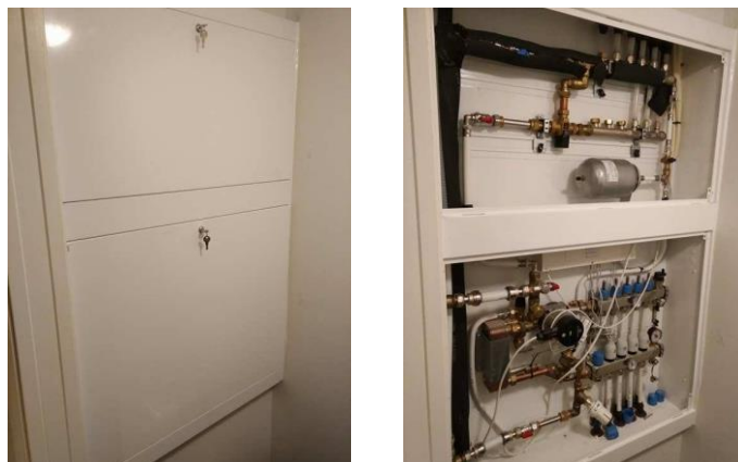
Figur 25: Fotografi av vekslerskap i drift
