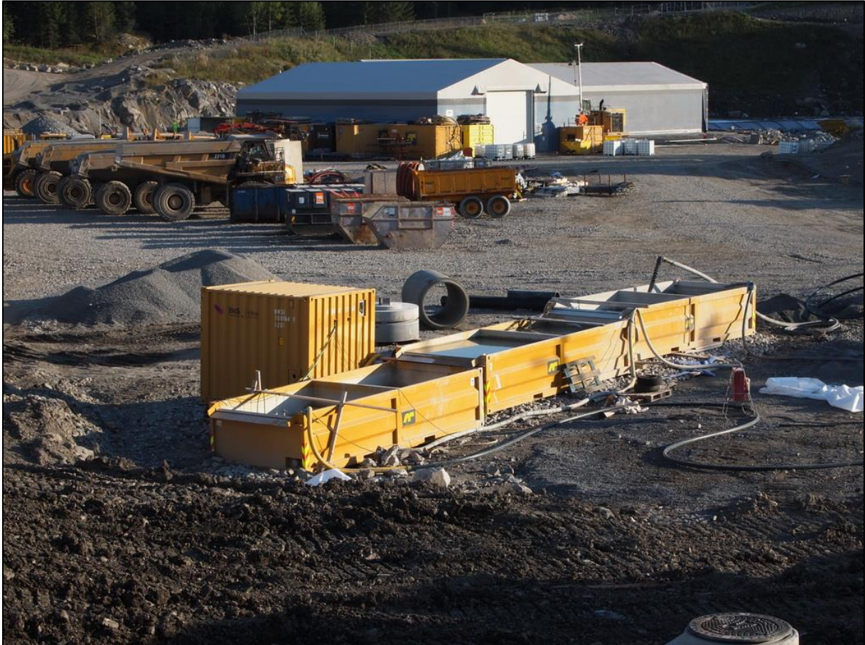
Bilde 4 Sedimenteringsbasseng og renseanlegg (bjorndal.no, 2014)
