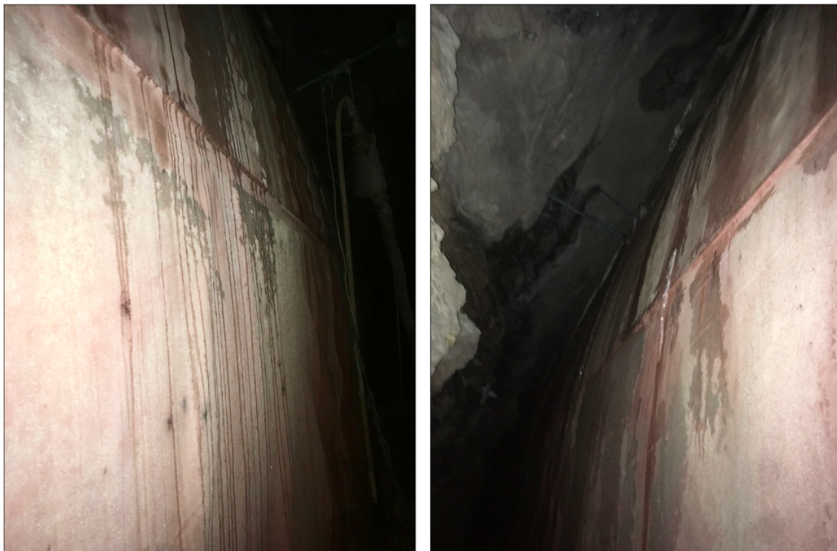
Figur 6.2: Utsikta bak kvelv frå inspeksjonsluka på strekninga, ca ved 78 meter. Ein kunne ikkje sjå langt, men ein kunne sjå fukt og høyre drypp. I tillegg kunne det skimtast ein kabel (t.h. i venstre bilete).
