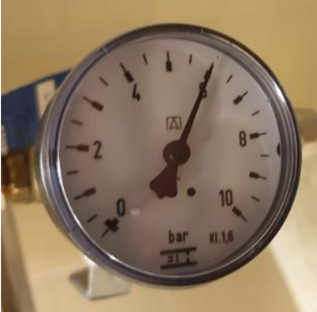
Figur 8 Avlest trykk i forkant av servant i kjeller på Kunnskapssenteret.
