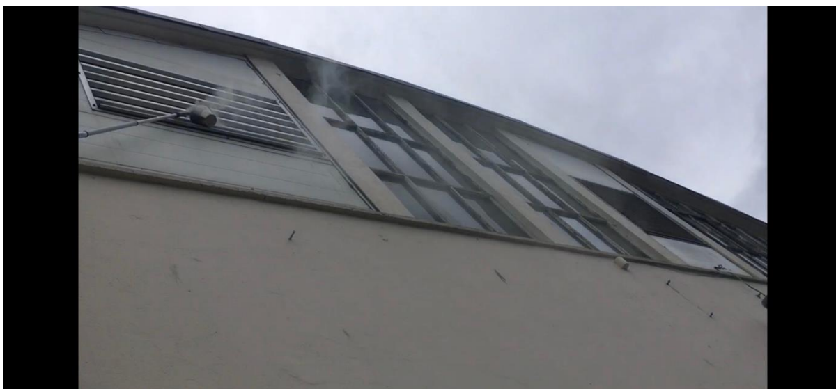
Figur 5: Røykforsøk for undersøkelse av mulig kortslutning
