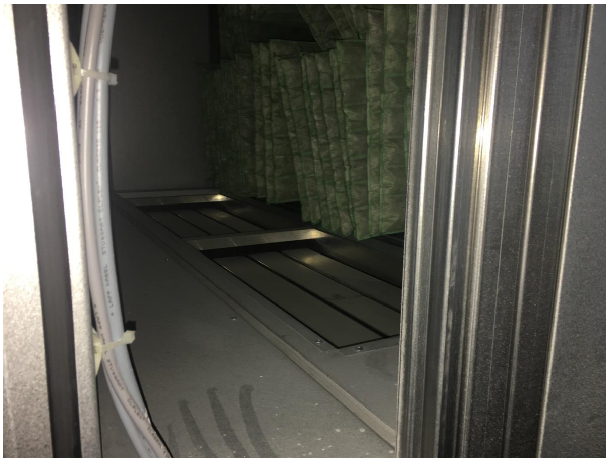
Figur 27: Bilde som viser kalkstøv etter F7 filter i avtrekket.
