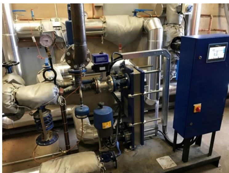
Figur 15 En varmeveksler som veksler fra damp til vann hos Strand Unikorn, tilsvarende en som kan settes inn for å kobles til fjernvarmenettet.
