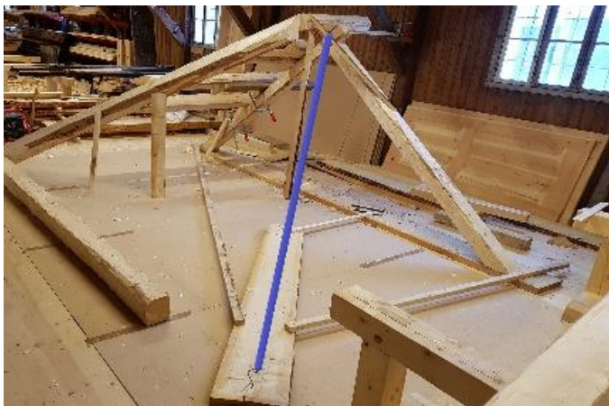
Bilde 103 Snoren er markert med blå strek fra takfoten, opp til møne ved anleggsbindet.
