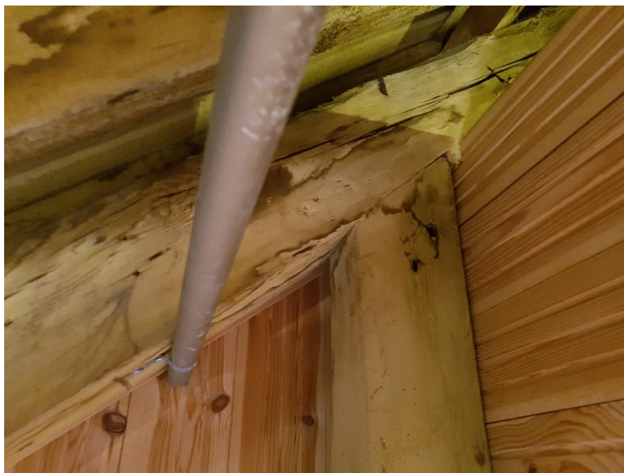
Bilde 58 Stolpe under skiftesperre i valmen, men tå opp i skiftesperret.
