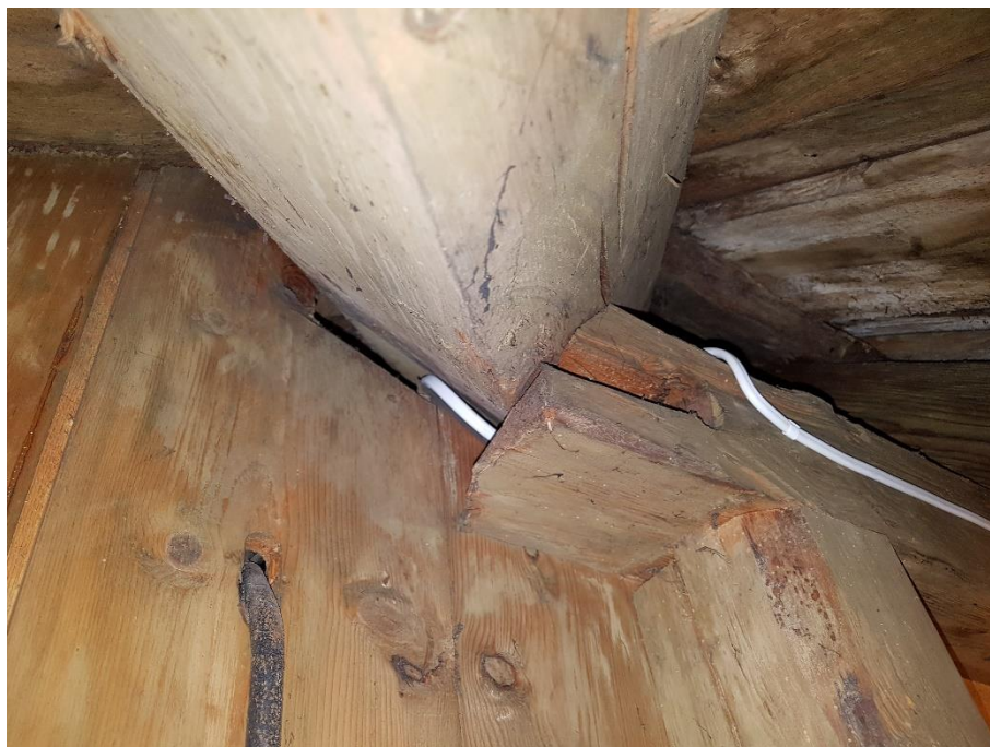
Bilde 57 Rammen på kneveggen treffer bort i gratsperret.
