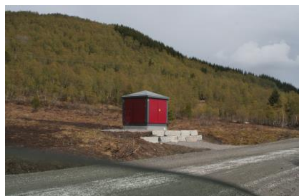
Figur 4.3: «Trafokiosk med uheldig fargevalg/materiale». (Sykkylven kommune, 2014A)
