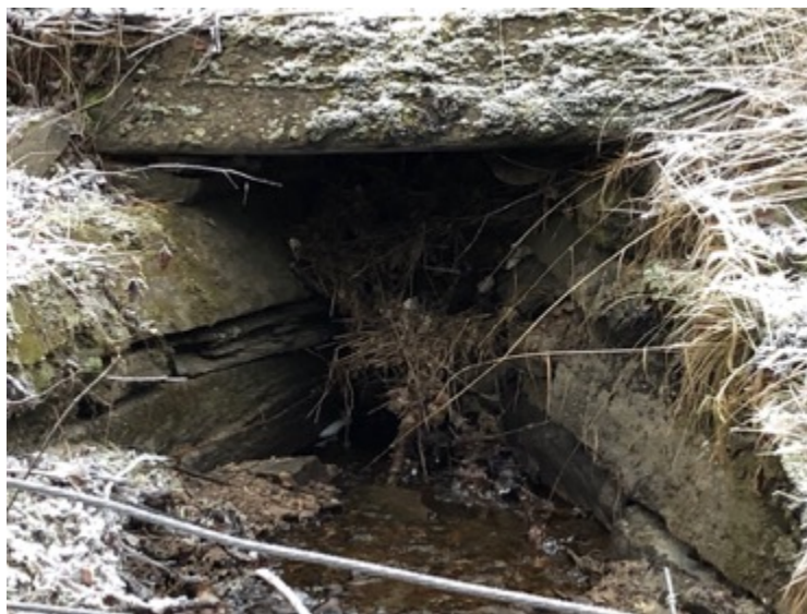
Figur 2: Kilnesbekken forlater eiendom (gnr. 220, bnr. 1) i et rør under jernbanen (her fra oppstrømssiden). Røråpningen er fortettet av biologisk materiale.
