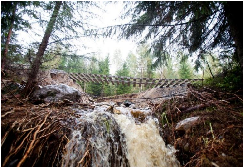
Figur 3.9: Bildet viser et eksempel fra Rørosbannen i 2011, hvor store mengder oppdemmet vann som følge av tett stikkrenne har ført til brist av fylling (Scanpix, 2011b).
