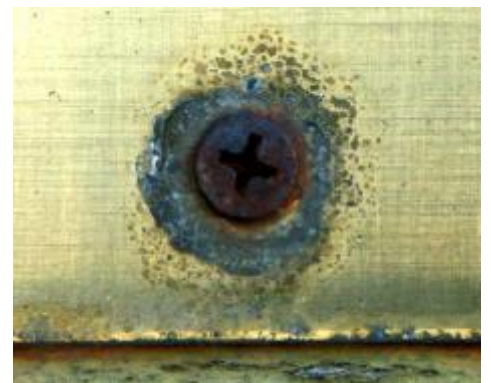
Figur 7: Galvanisk korrosjon mellom skruehode og bakplate [22]
