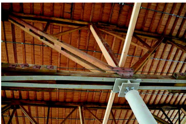
Forsterkning av fagverk ved bruk av stålsøyler og tre- og stålforbindelser (Foto: Byantikvaren)
