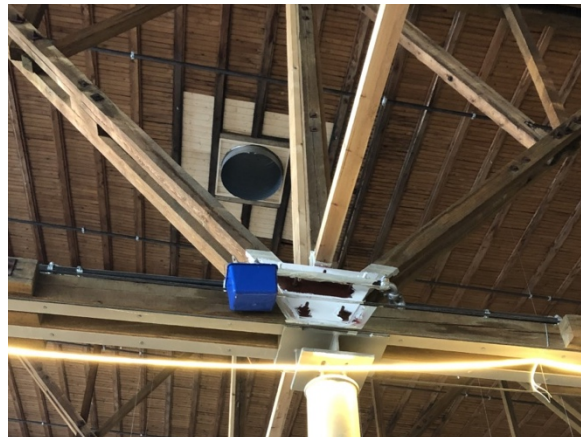
Figur 31: Brannmaling av knutepunkt (Foto: Ingrid K. Storror)
