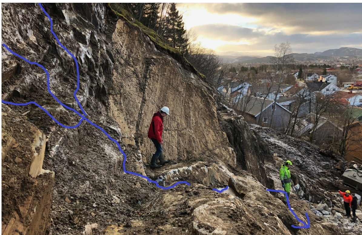
Figur 20: Observasjon av rennende vann i skråning.
