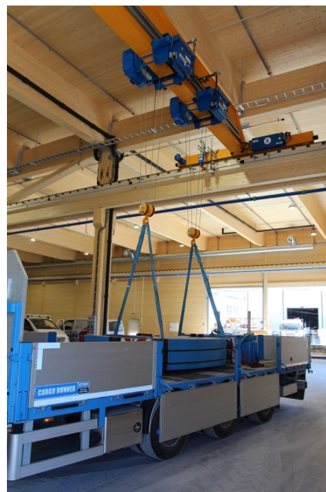
Figur 4.1 - Kran og kranbane. Figur: Green Advisers AS
