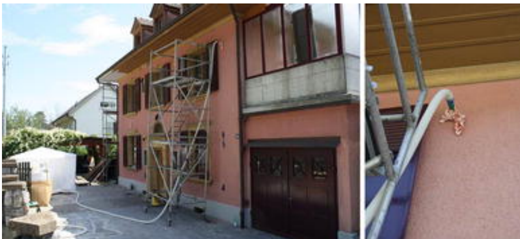
Figur 12: Til venstre illustreres veggen som skal etterisolereres og til høyre et nærbilde av innblåsningshullet [27].
