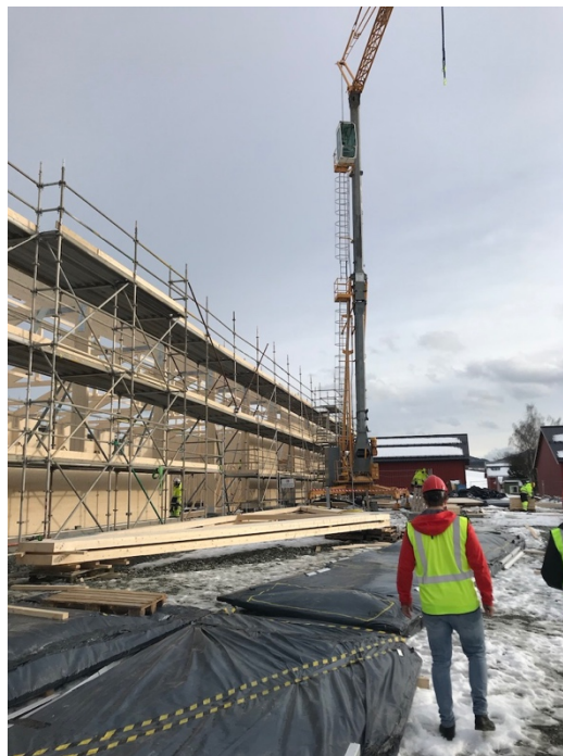
Figur 14 - Befaring på Skjetlein vgs, privat bilde
