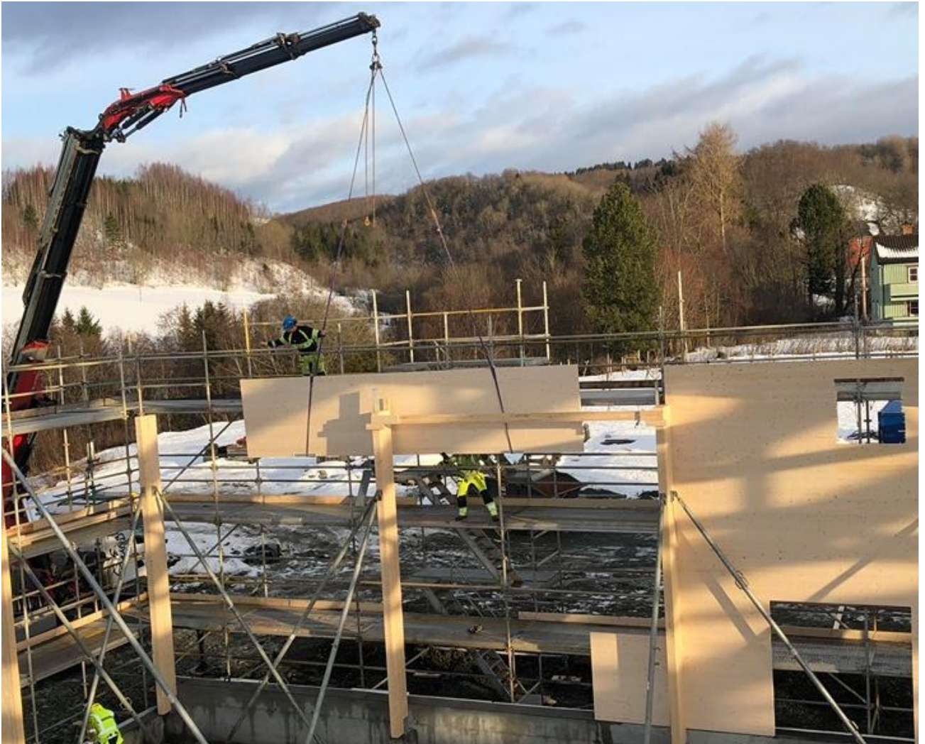
TRONDHEIM: I 2019 ble det satt opp et lager i massivtre ved Skjetlein videregående skole. Foto: Hege Husby.
