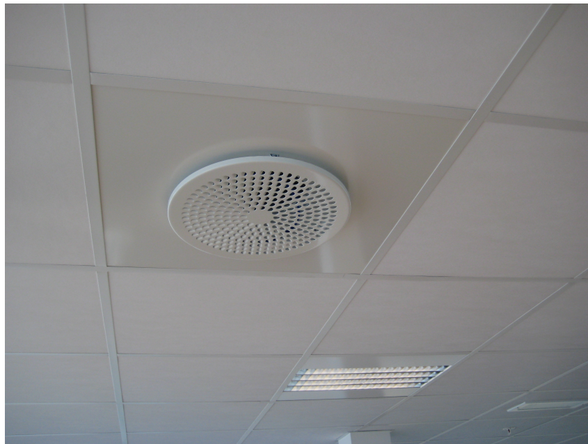
Figur 2.4: Åpningen fra kanalsystemet er dekket av hull satt i formasjon, slik at lufta som kommer ut roterer noe og skaper sirkulasjon.
