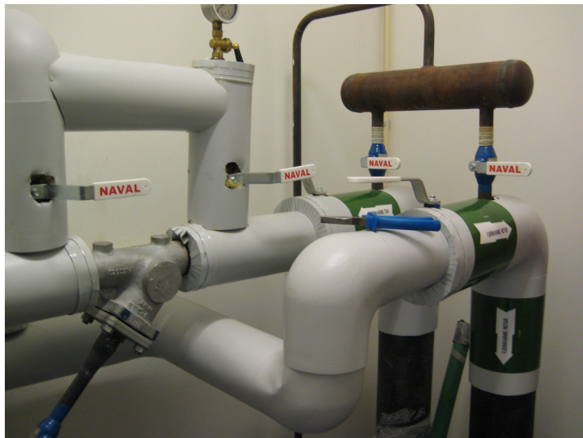
Figur 2.3: Tur- og returvannet som kommer fra fjernvarmeanlegget til Prediktor
