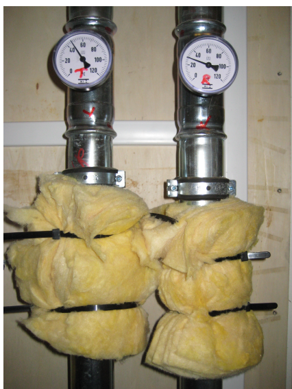
(a) Isolering av følere på rørene til radiatorene.
