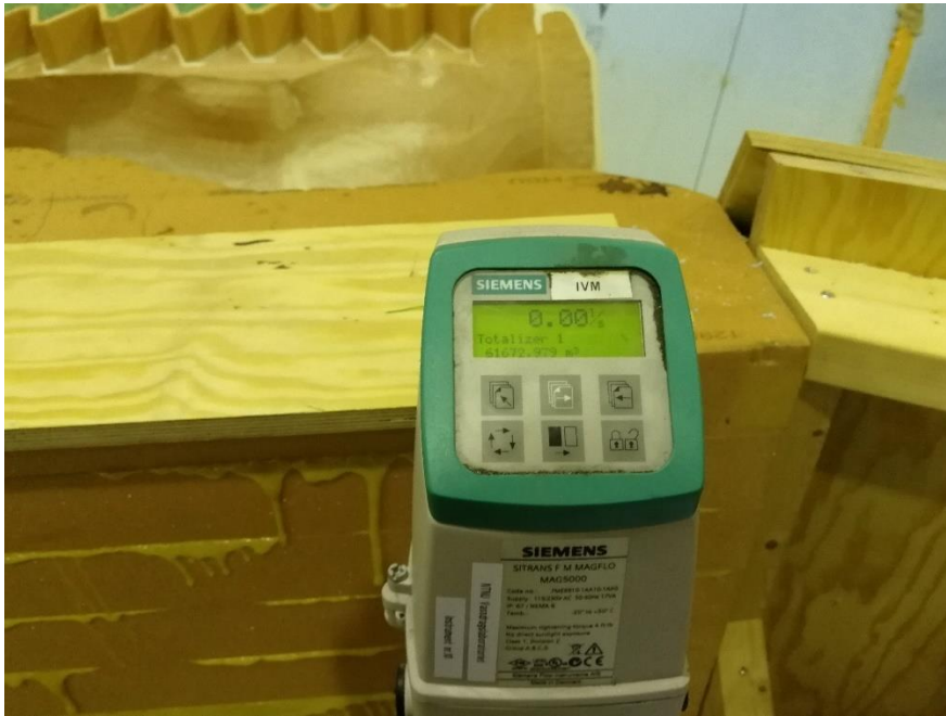
Figur 21 – Vannføringsmåler, Simens Sitrans M Magflo 5000.
